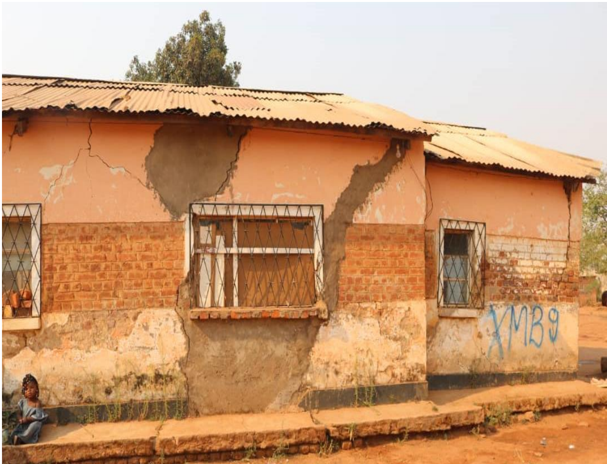
Maison de l'Église Méthodiste -Unie fissurée par les minages de l'entreprise COMMUS
